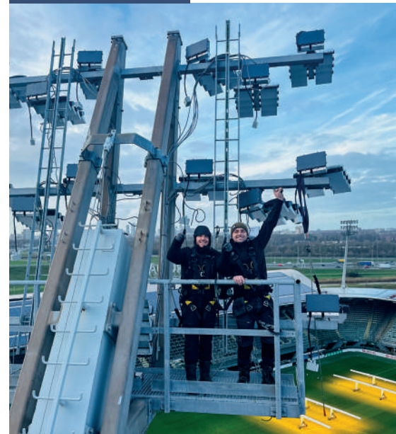
Installatie ADO Den Haag
